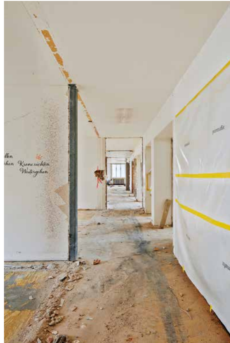
Die seitlichen Wände wurden entfernt, der Korridor in die Weite geöffnet. Wo nötig wurden nicht demontierbare Elemente geschützt.
