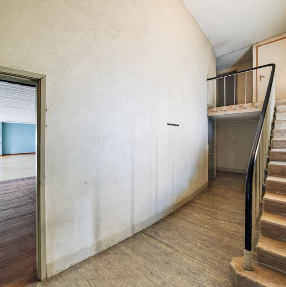
Der Bühnenraum enthielt in seinem ursprünglichen Zustand einige Elemente, die bei der Gesamtanierung abgebrochen wurden. Die Bühnenrückwand und die Erschliessung des Orgeltechnikraumes wurden zurückgebaut.
