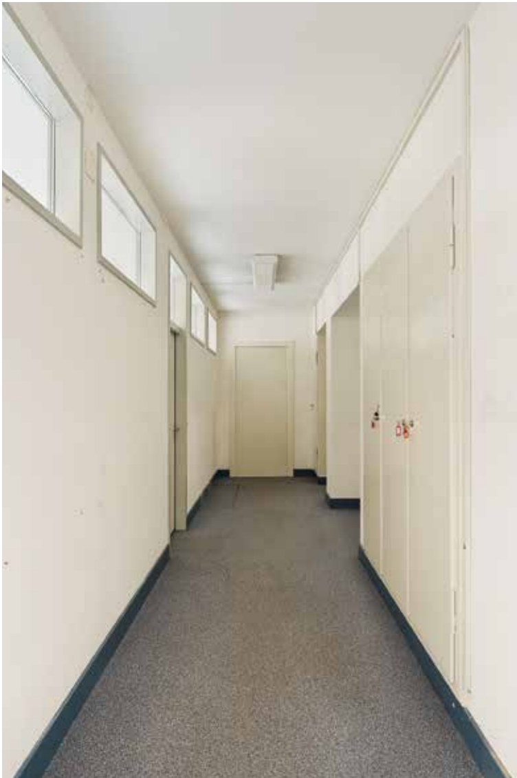
Der eng wirkende Korridor im ersten Obergeschoss vor dem Umbau. Die Türen und Schränke wurden mit ihren Beschlägen zurückgebaut und während des Baus extern gelagert.
