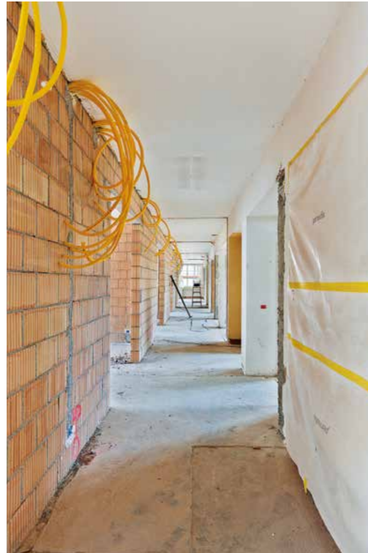
Neue Zwischenwände wurden eingezogen und eingespeist. Der Boden wurde neu aufgebaut, neue Glaswände und Türen wurden eingebaut.
